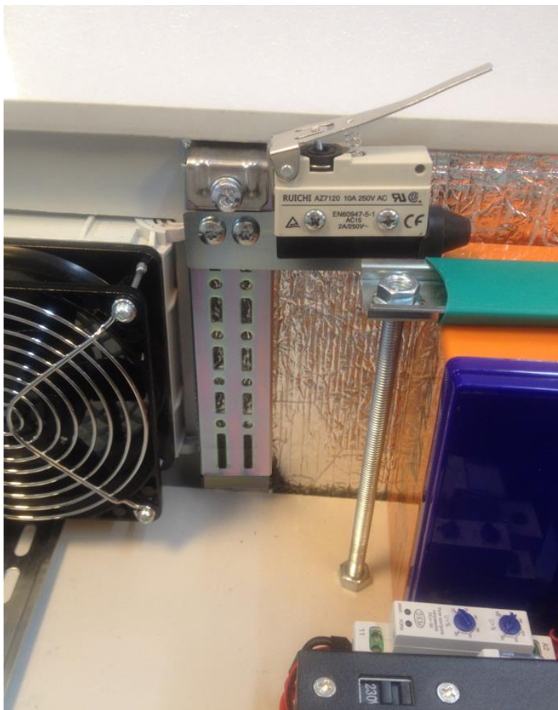
Рис.1 Датчик вскрытия установлен в уличную станцию OSP (пластиковый корпус).
