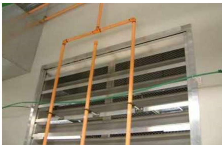
Рисунок 28 – Размещение труб с воздухозаборными отверстиями на воздухозаборной решетке системы вытяжной вентиляции
