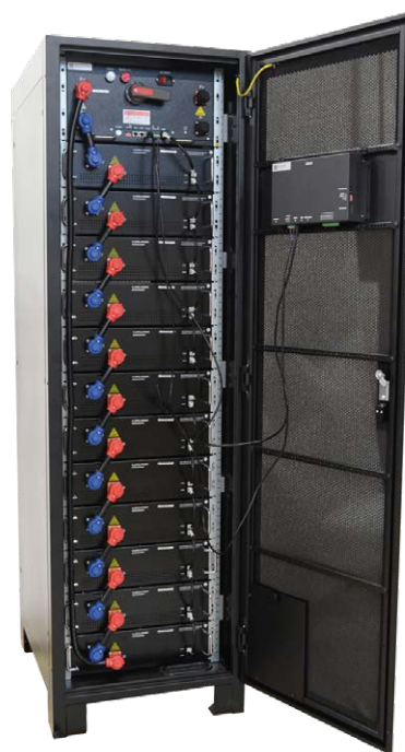
Кабинет LP с батарейными модулями
