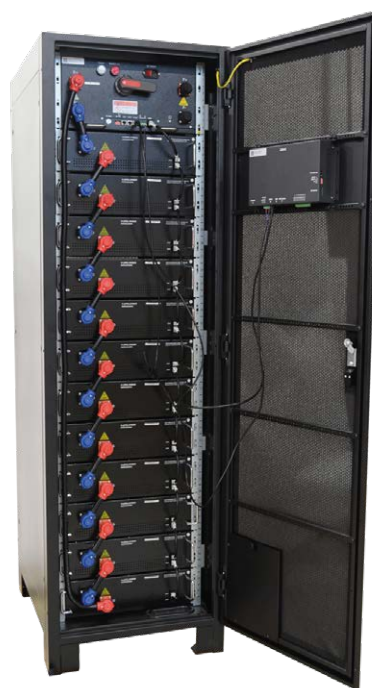
Кабинет LP с батарейными модулями
