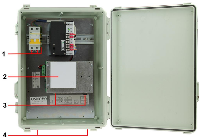
Рис.2 Коммутатор SW-60812/W, вид внутри
