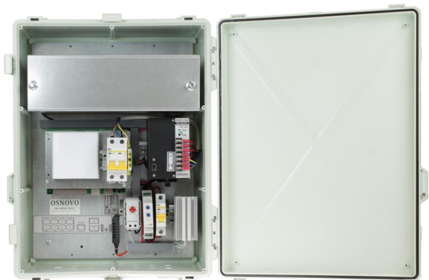
Рис. 2 Коммутатор SW-80802/WLU, вид внутри
