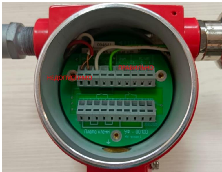
Рис.5 Неправильный монтаж, не должно быть оголенных проводов
