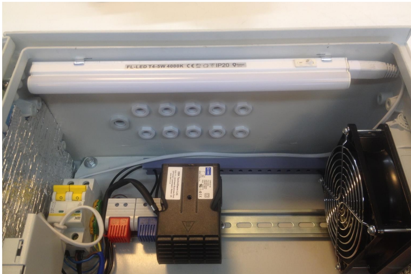
Рис.3.2.3-1 Светильник, установленный в пружинные крепления шкафа OSP.
